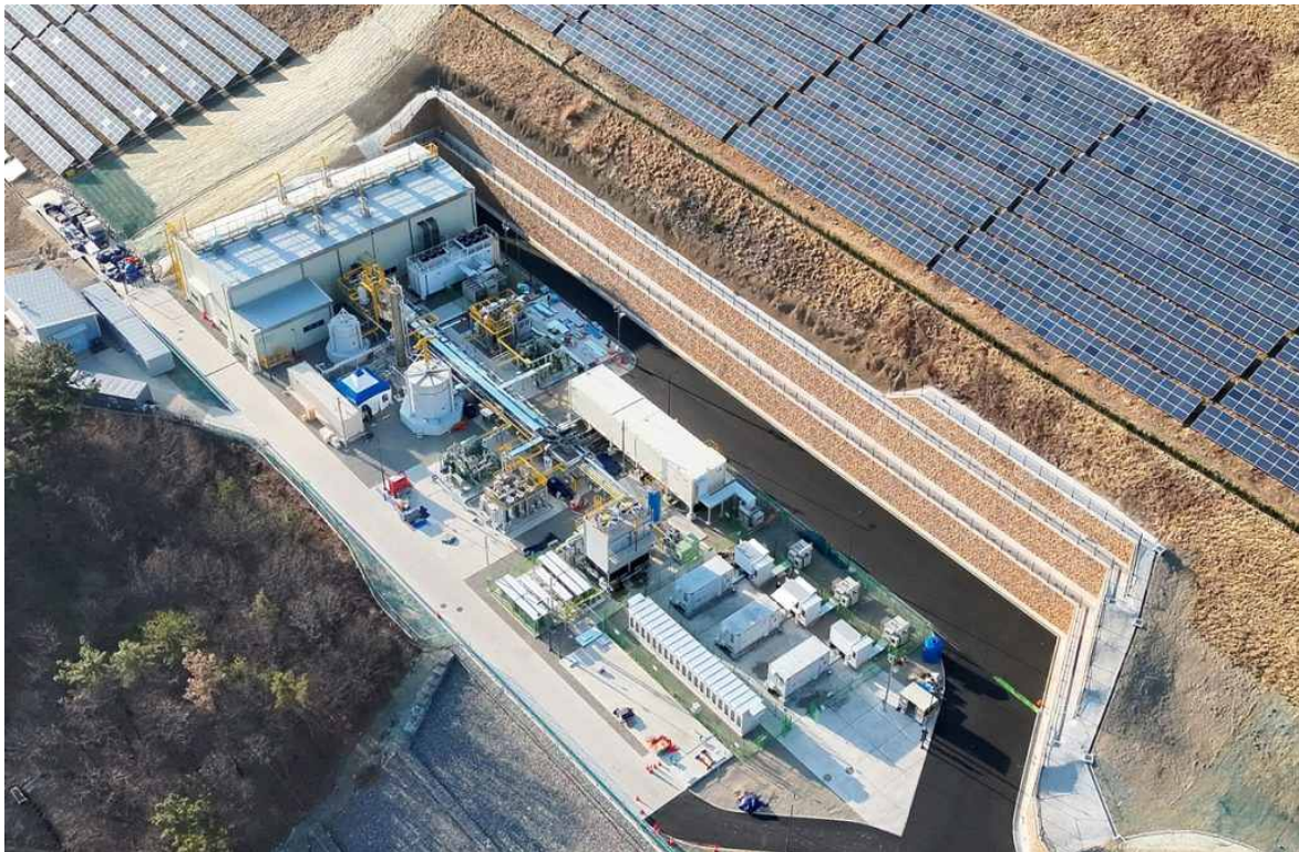
[그림] 삼성의 10MW 태양광 기반 수전해 실증 계획
