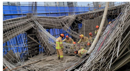
[그림] 건설 현장 안전사고
