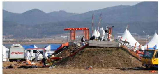
2일 전남 무안국제공항 제주항공 여객기 참사 현장에서 항공-철도사고 조사위원회(ARAIB) 관계자들이 로컬라이저(방위각 표시 시설)가 설치된 콘크리트 둔덕을 조사하고 있다. [뉴시스]
