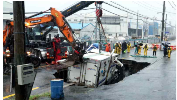
<부산 학장동 싱크홀 사고, `24.9>
