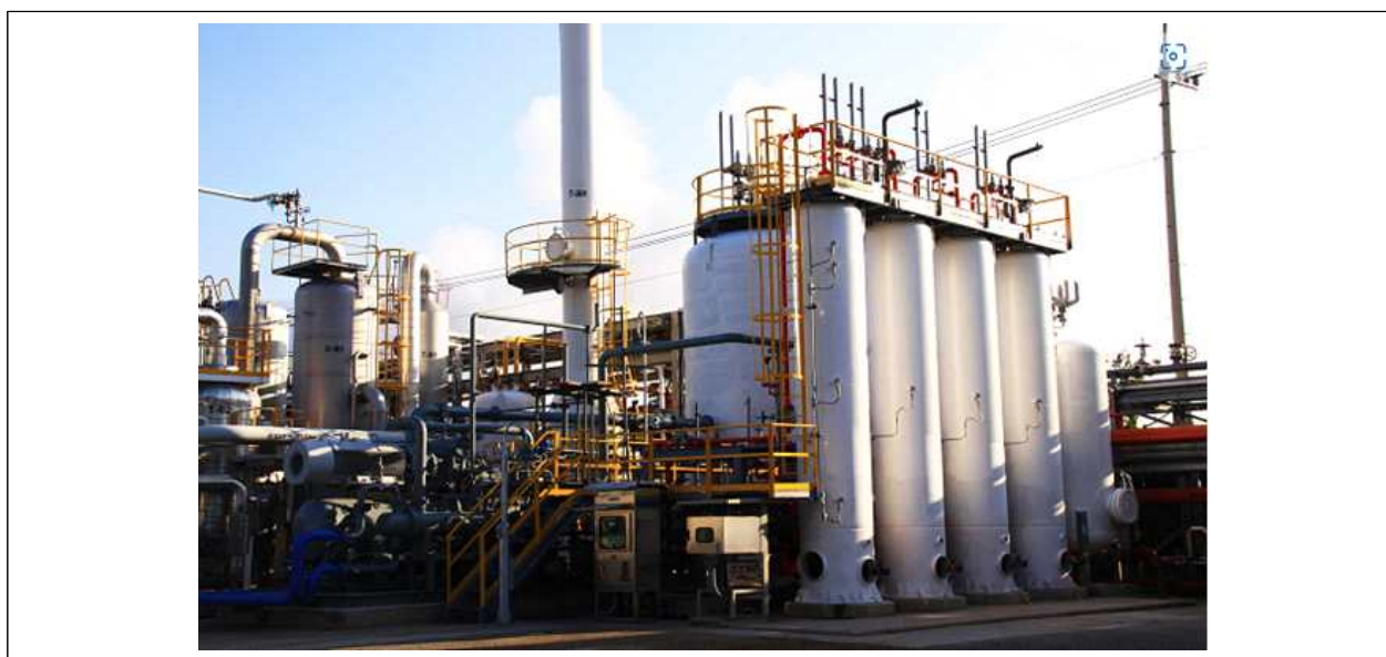
[그림 VI-17] 전남 여수공단 설치된 고순도 수소 PSA 설치 사례 (한국에너지기술연구원, 2018년)
