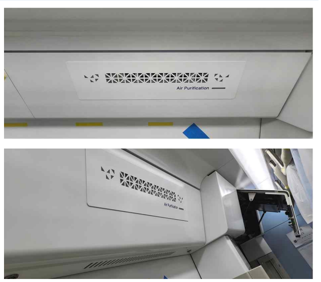
한국철도공사(KORAIL)_GTX-A 전동차 공기질 개선장치 제작 및 설치
