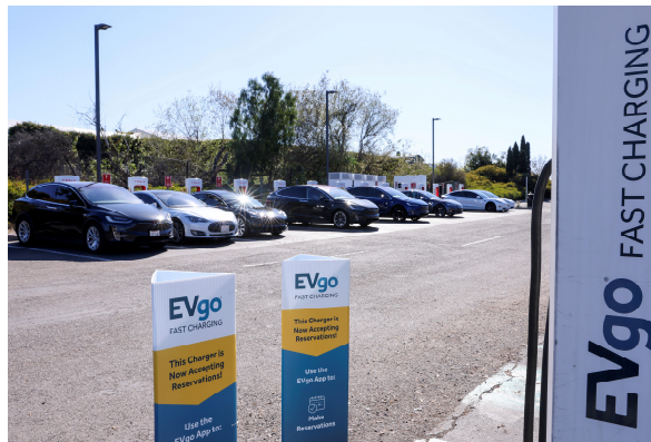
[그림] 미국 캘리포니아주에 설치된 전기 충전소
