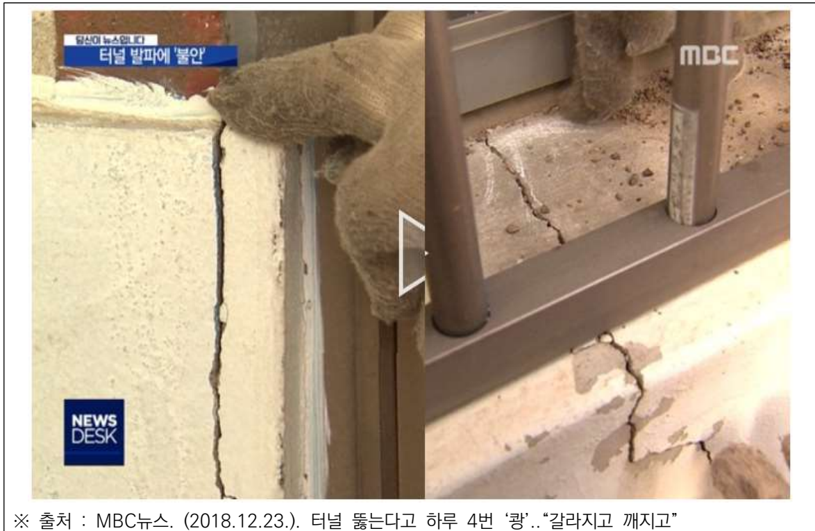
[그림 2-16] 발파로 인한 건축물 균열 사례
