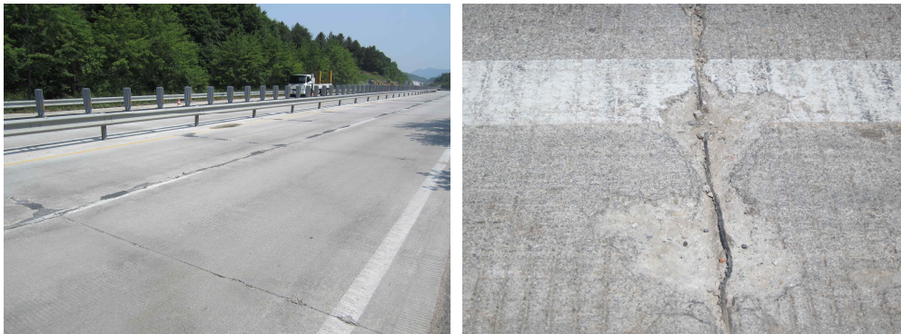
〈콘크리트포장 줄눈부 파손사례〉
