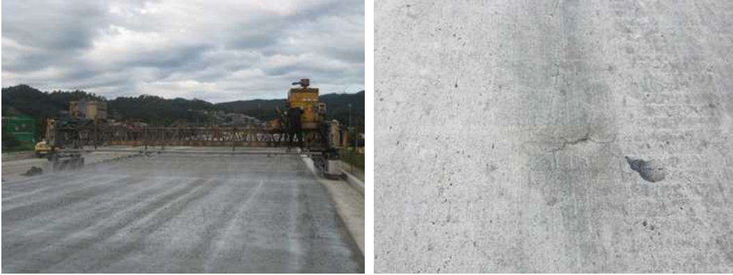
〈양생제 부적절 살포에 따른 콘크리트 표면 파손 형상〉
