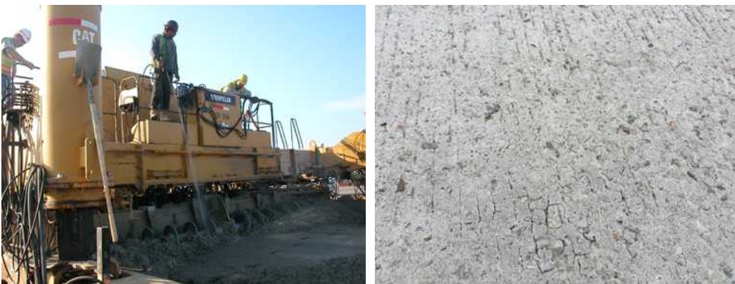
〈현장 가수에 따른 콘크리트 표면 파손 형상〉
