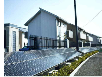
그림 95. 도로를 따라 설치된 태양광발전패널
