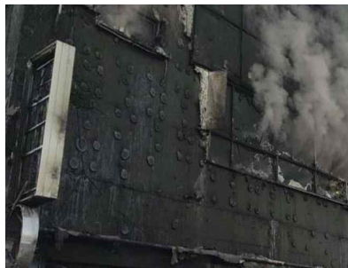
단열재 부착방법의 잘못
