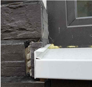
빗물받이의 잘못된 시공
