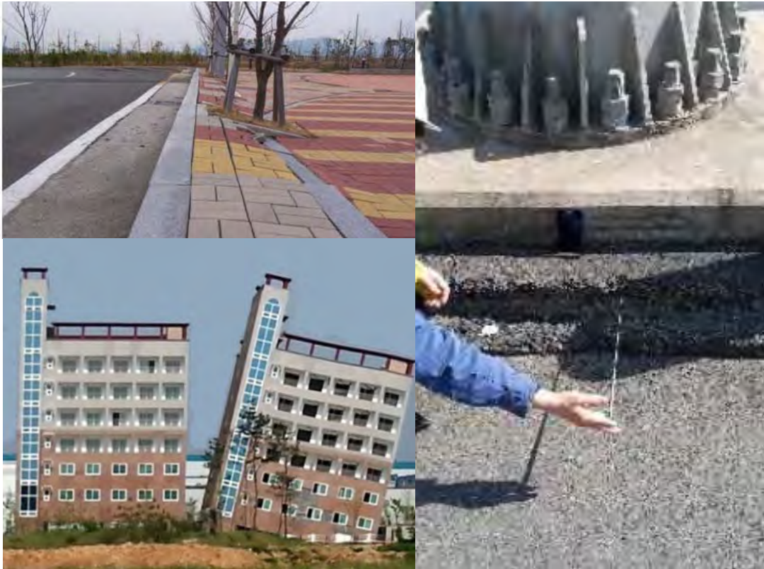
[그림 1-6] 연약지반 개량 후 부등침하 발생 사례
