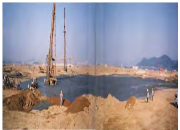
<인장파괴로 인한 장비 함몰 및 전도>
