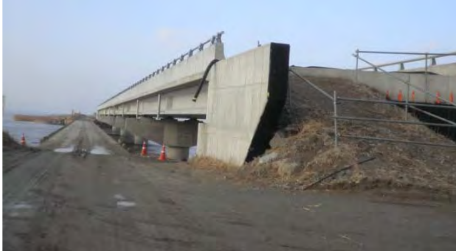
[그림 1-8] 서산 간척지 방수제 도로 침하 발생 사례
