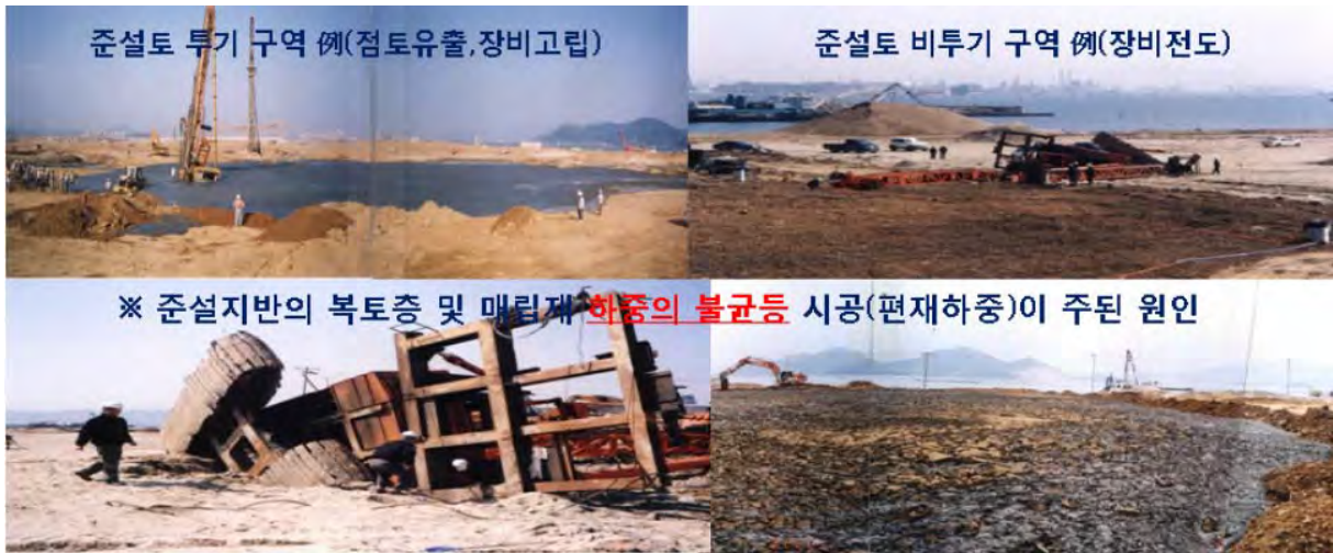
[그림 1-5] 연약지반 개량 시공 중 지반의 파괴 및 장비의 전도
