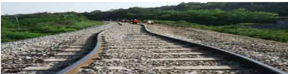
<일반 도상구간 횡저항력 부족으로 발생한 장대레일 좌굴 전경>
