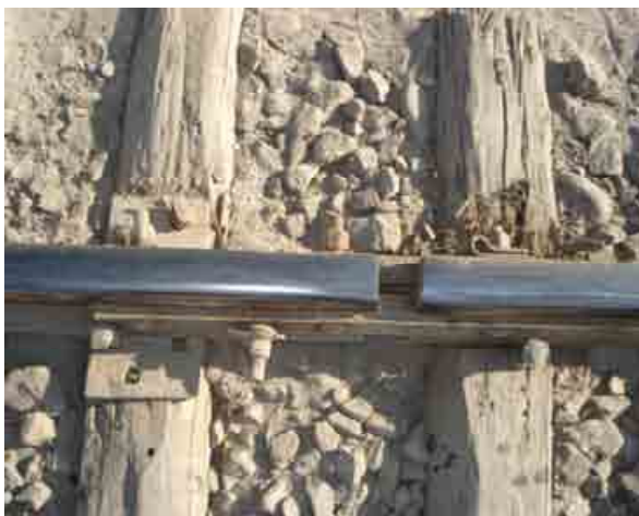
<레일 이음매부 과대유간 상태 현황>
