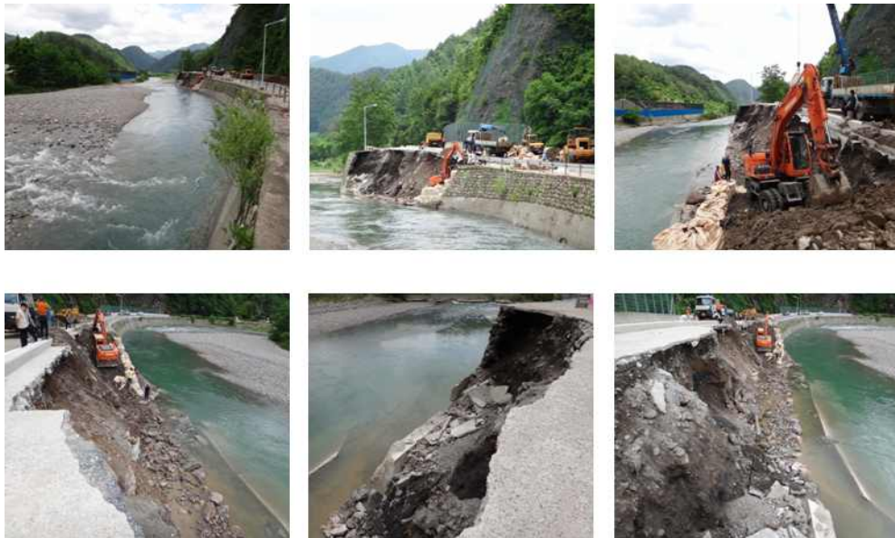
그림 31 산지하천 수충부 옹벽 피해 현황
