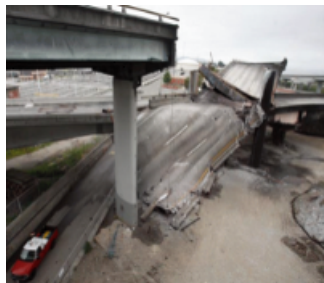
(b) 유조차량의 충돌 후 폭발로 인한 교량붕괴(미국 캘리포니아)
