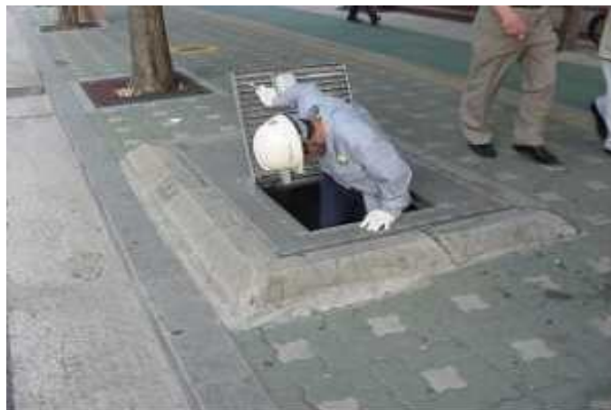
<그림 1.20> 공동구 출입구의 단면 부족
