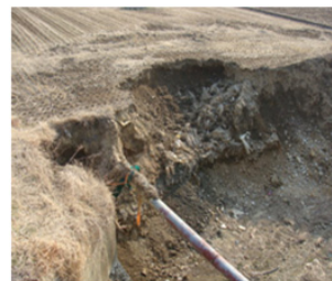
〈그림 2-23〉 지하매설물 파손과 지하수 영향에 의한 지반침하
