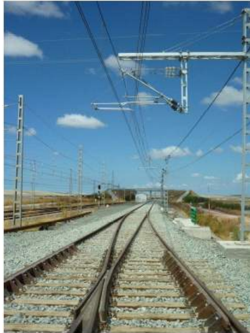
<DC3kV 분기점 (스페인 CA220)>
