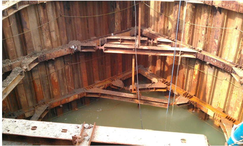
[그림 2.6] 내외 수위차가 심한 구간의 강널말뚝 가물막이 하자사례
