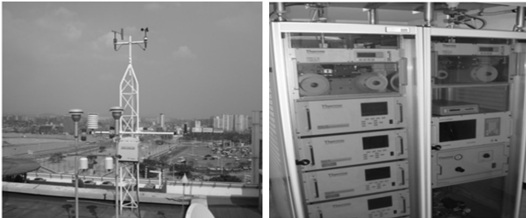
<그림 5-13> 한국공항공사 대기질 측정 장비
