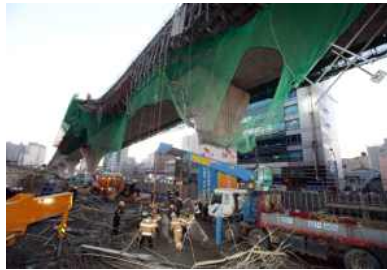
부산 남북항대교 연결 고가도로 붕괴 (2013)
