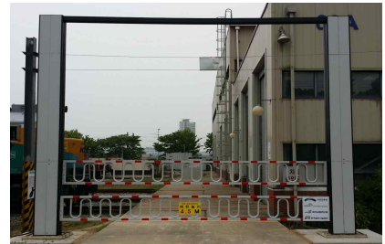
< 오송 RPSD 설치 >
