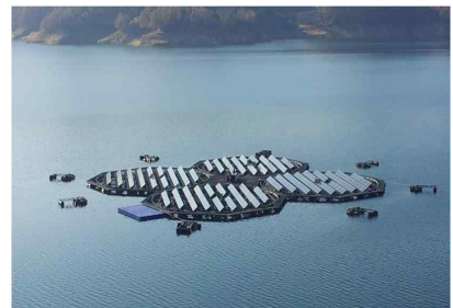
< 추적식 수상태양광 전경(합천댐) >
