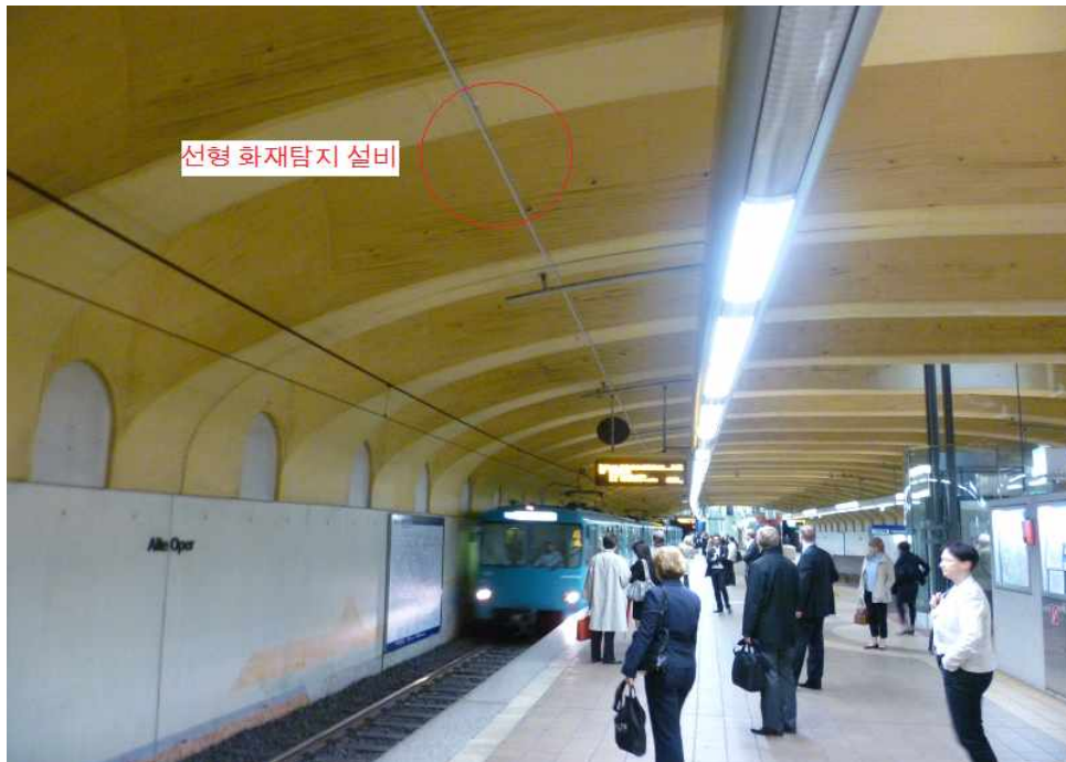
그림 75. 선형 화재탐지 설비 설치 사례(리스트텍, 독일)
