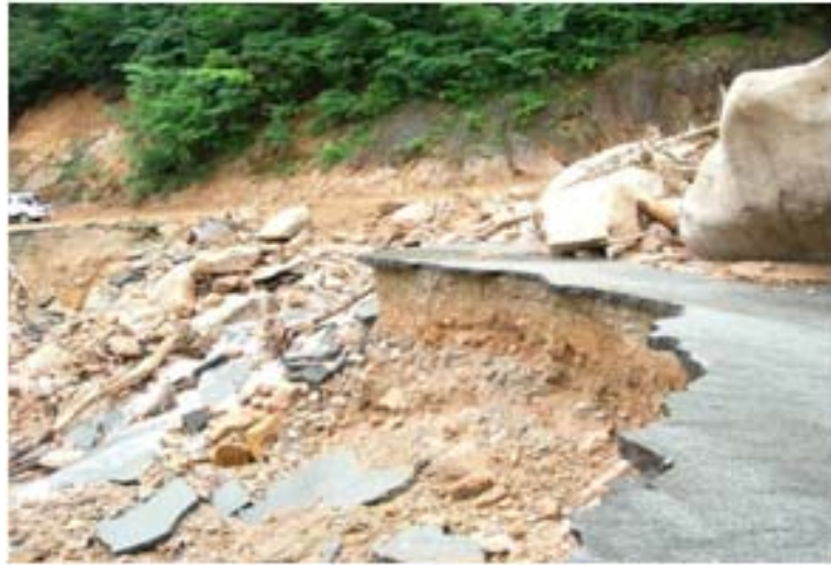
그림 3.9 토석류로 인한 도로 유실
