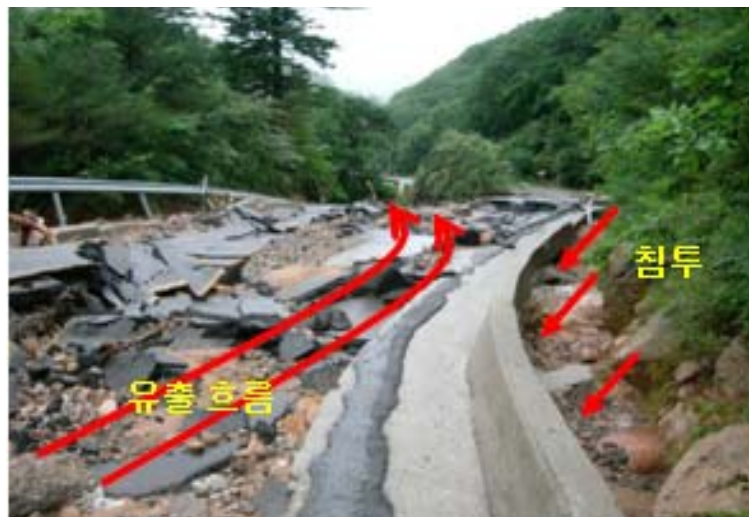
그림 3.6 도로 하부지반 침식으로 인한 도로 유실
