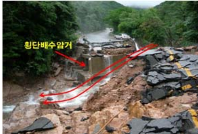
그림 3.7 배수용량 초과로 인한 도로 유실
