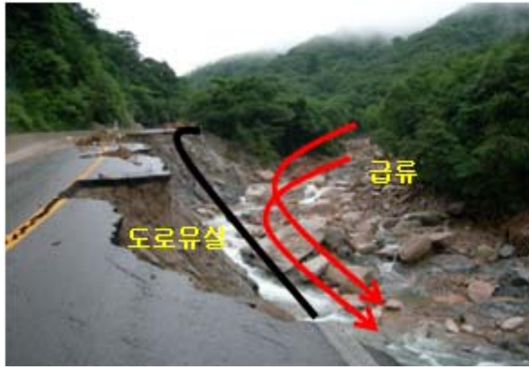
그림 3.5 도로 하부지반 침식으로 인한 도로 유실
