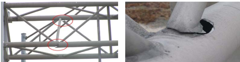
그림 5-7 Failed Sign Support Truss
