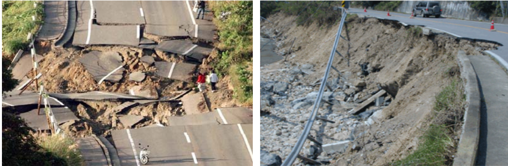
그림 5-10 도로배수시스템문제로 인한 도로파손
