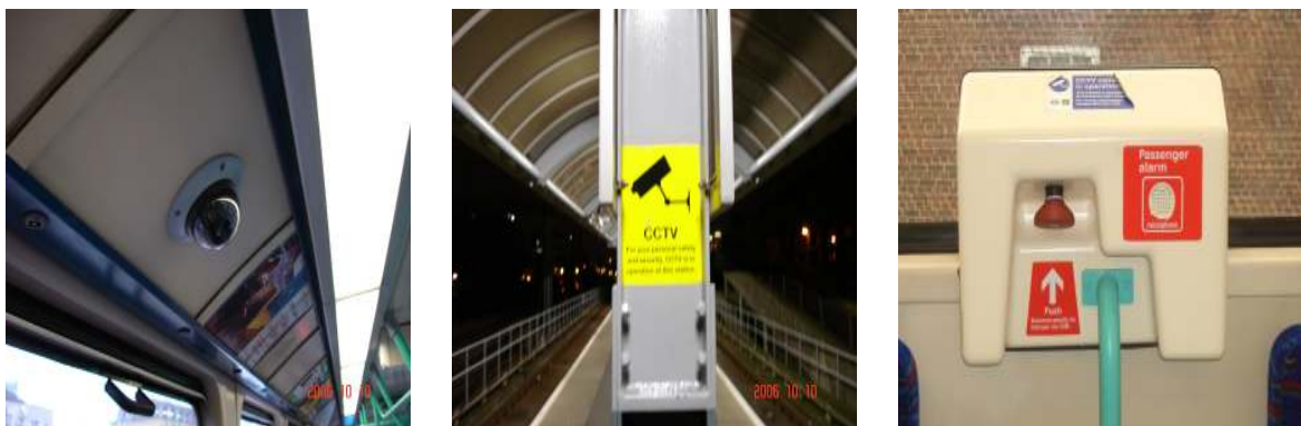
[그림 2-18] 지하철 CCTV
