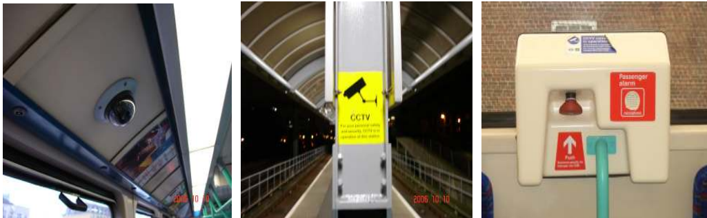
[그림 2-24] 지하철 CCTV
