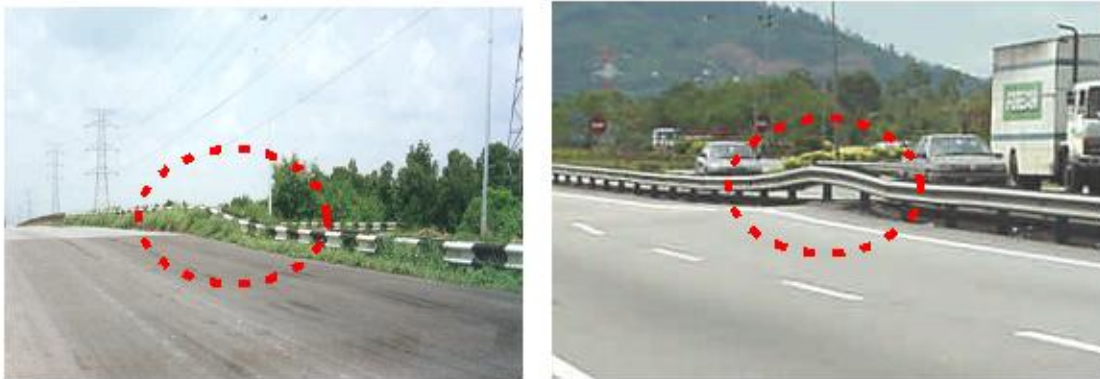
그림 6.8 연약지반상에 건설된 도로구조물의 각종 파손형태
