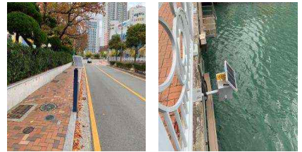
< 침수 및 하천수위 감지장비 설치 >
