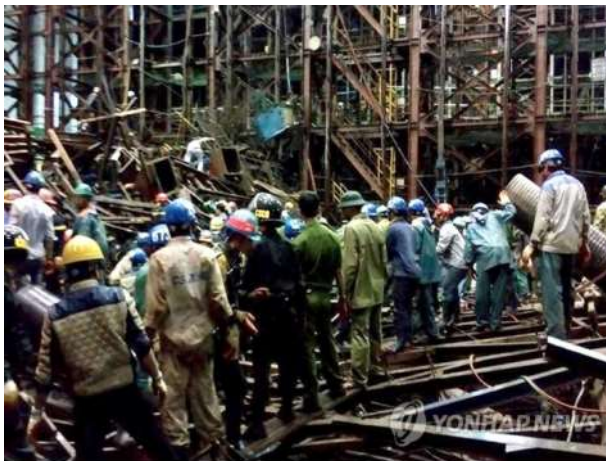
(a) 하띤성 건설현장 붕괴 사고(2015)
