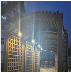
낮은 가로등을 응용한 태양광 가로등 설치(안성시)
