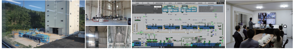
한국지질자원연구원 포항센터에 건설된 이수순환통합플랫폼 내외부 사진
