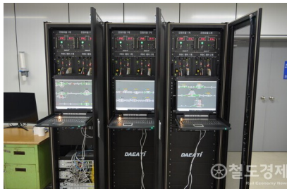
〈KTCS-2 전라선 시범사업 RBC 설치〉
