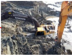
작업현장 굴착기 전도 작업현장 굴착기 전도
