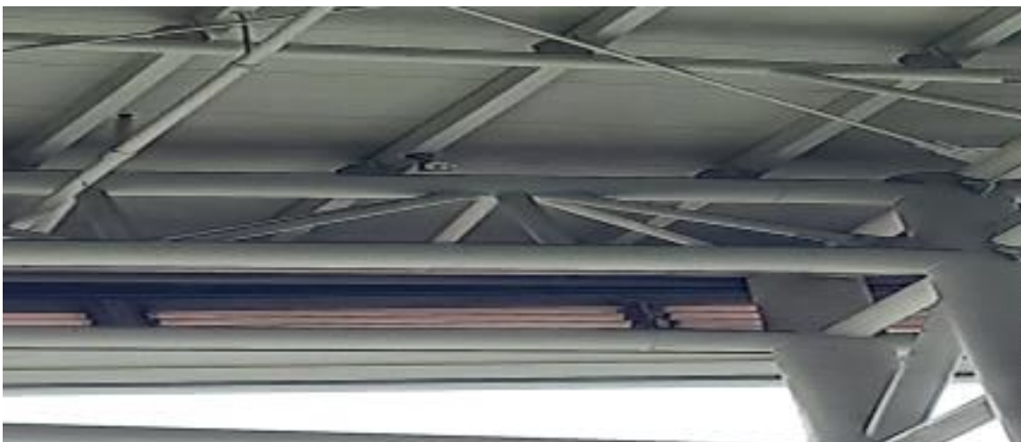
그림 2-2-2 불꽃감지기 설치 장면
