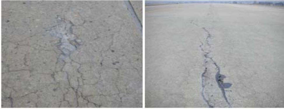
<그림 3.2> 공항 콘크리트 포장 파손 형태
