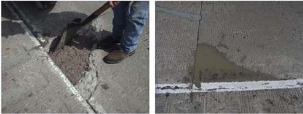
<그림 2.15> 복구 3년 후 콘크리트 포장 상태(재료 B)
