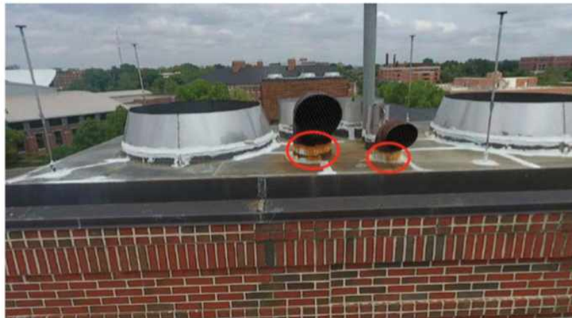
그림 6. Coverdell Center에있는 두 개의 굴뚝의 남쪽. 이 빌딩의 HVAC 시스템을 육안으로 검사하는 동안, 칼 쿨러 실린트 및 통풍구가 관찰되었으며 피뢰침과 주변 벽돌의 전체적인 마모가 관찰되었다.
