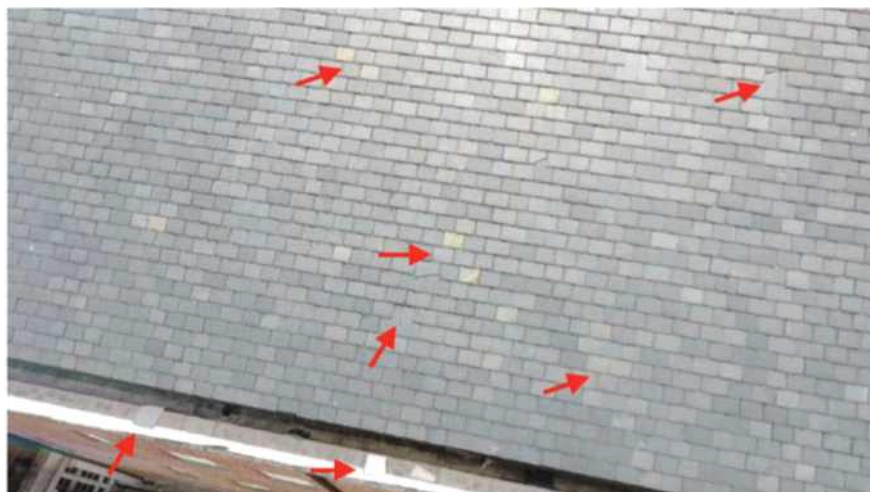
그림 9. Miller Learning Center 지붕의 북쪽. 이 사진은 슬레이트 얼룩변색, 균열 및 파손을 보여준다. 빗물과 열로 인한 미네랄 함유 물은 이러한 피해를 초래할 수 있다. 사진 맨 아래에는 얼룩변색이 떨어지는 것과 비슷한 것으로 보인다.
