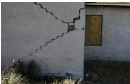
(b) 외부 벽의 균열
