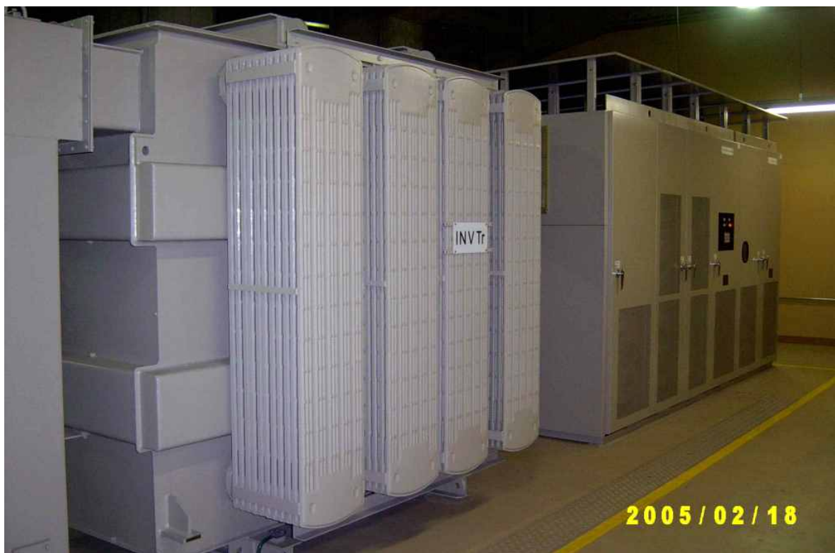
[일본 신마루코변전소의 회생인버터 및 변압기]
