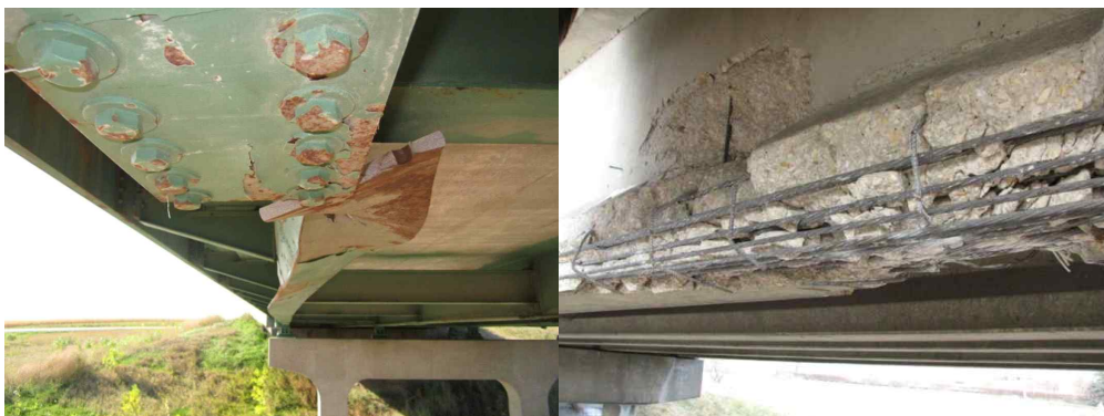
그림 3. 아이오와주 교량 손상의 예.
