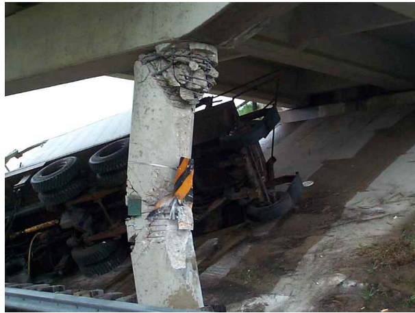
그림 7.미네소타주 트럭 충돌로 인한 기둥 구조 손상의 예
