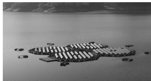
그림 51 합천 100kW 추적식 수상태양광발전 시스템
