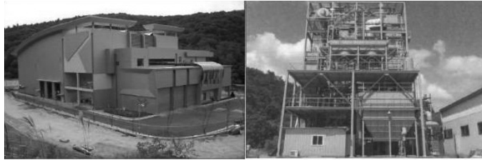
그림 68 고품연료 제조시설과 고품연료 전용 순환유동층발전시설
