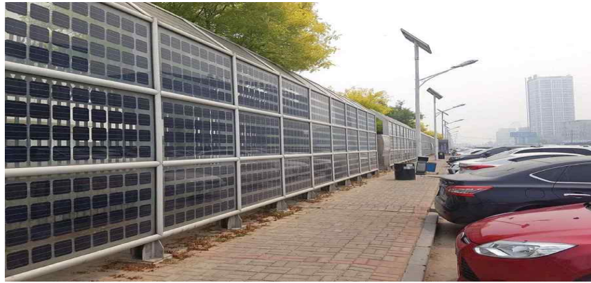
[그림 3] 메리츠테크놀로지사 태양광 방음벽 시공 사례
