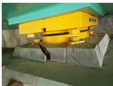
(1) 받침장치 몰탈 파손 1
