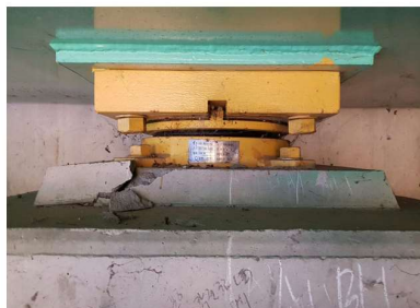
(2) 받침장치 몰탈 파손 2
