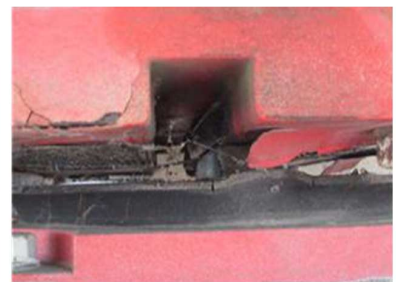
(3) 받침장치 파손 (하중초과)
