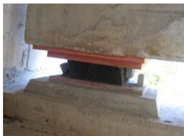
(4) 받침장치 영구변위 발생 및 썬기 파손
