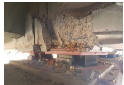
(6) PC빔 단부 콘크리트 박락
