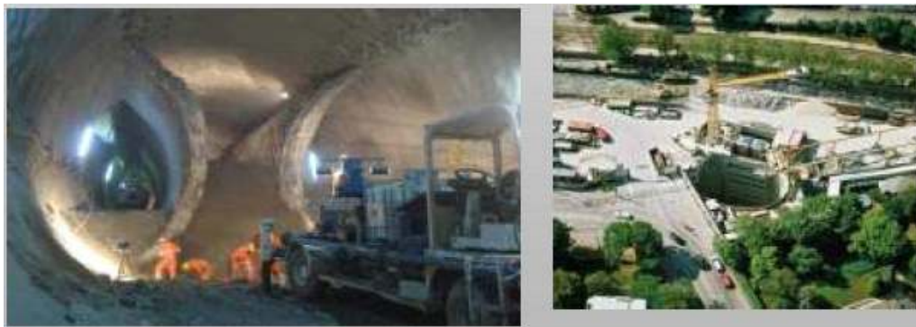
<그림 2-43> 오스트리아 Lainz Subway Tunnel 지열 시스템
