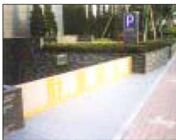
<주차장의 가동식 방수판(전면)>
