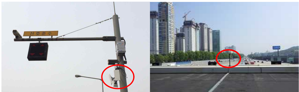
<그림 17> 지향성 안테나의 설치 예(3방향, 노변) <그림 18> 무지향성 안테나의 설치(서울영업소)
