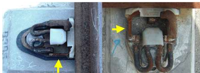
그림 2 철도교량 단부에서의 레일체결장치 손상 사례
