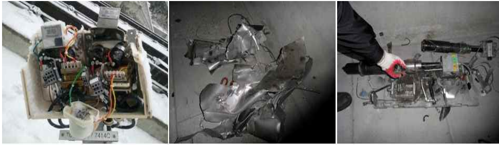
그림 11 신호설비 파손(좌 : 궤도회로 설비, 중 : 보호덮개, 우 : 밀착검지기)
