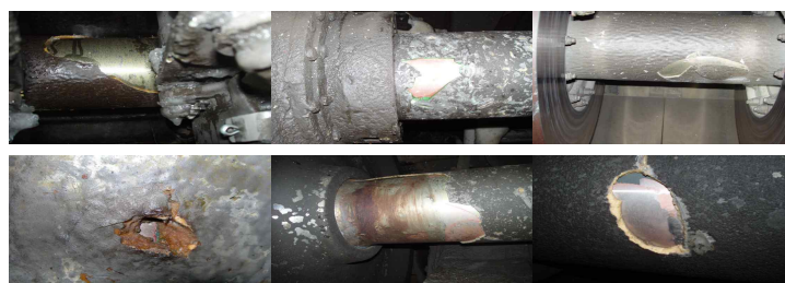
그림 8 차축 보호재(테로텍스) 파손
