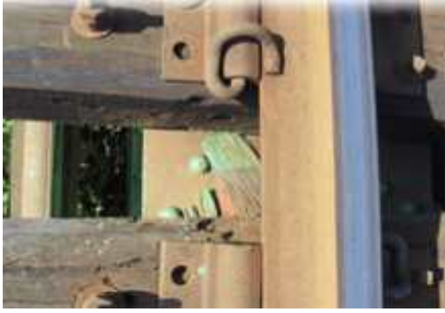
< 진동에 의한 패킹 탈락 >
