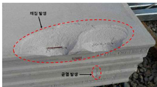
(a) ALC 패널 깨짐 및 균열 발생
