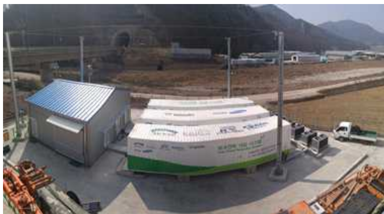
피크전력 저감장치 설치 전경
