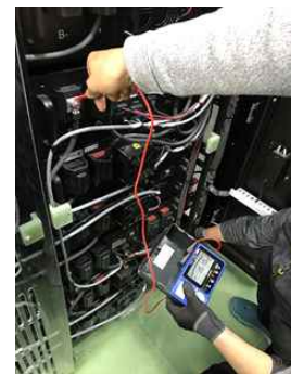
(d) Rack B- / Bank Frame
