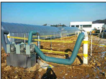
[실험기기 설치] Blower, 온도 센서
