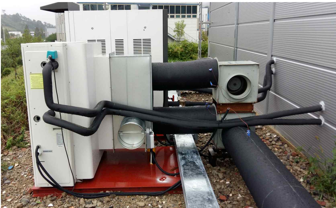
[그림 3-83] 히트펌프 , 칠러 배관 및 GAHX 지중열교환기 연결
