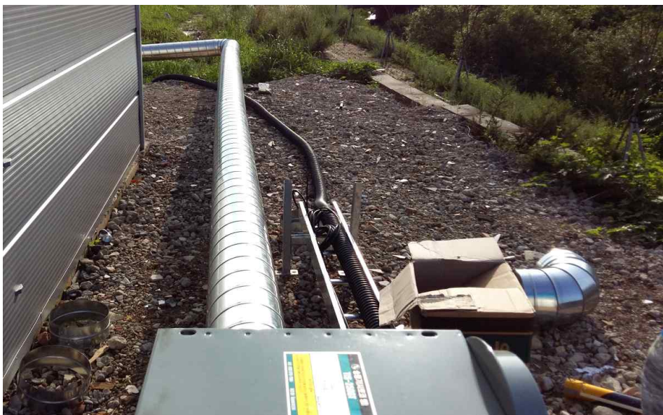
[그림 3-81] GAHX 지중열교환기 송풍기 연결
