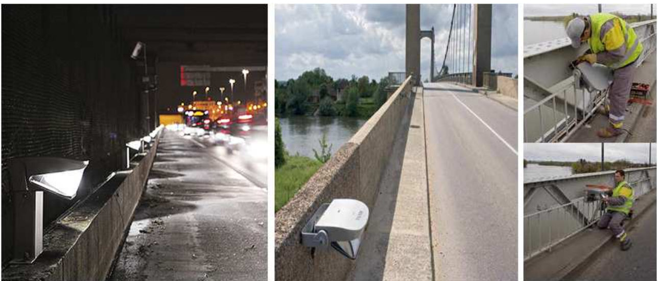
<ZUMTOBEL사의 ORUS 제품 설치 및 유지관리 전경>
